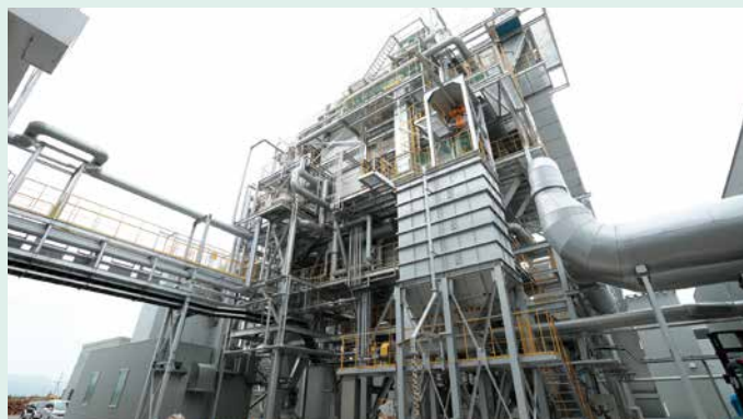
(株)津軽バイオマスエナジー 平川発電所 間伐材などの未利用材を活用したバイオマス発電を行っています。
